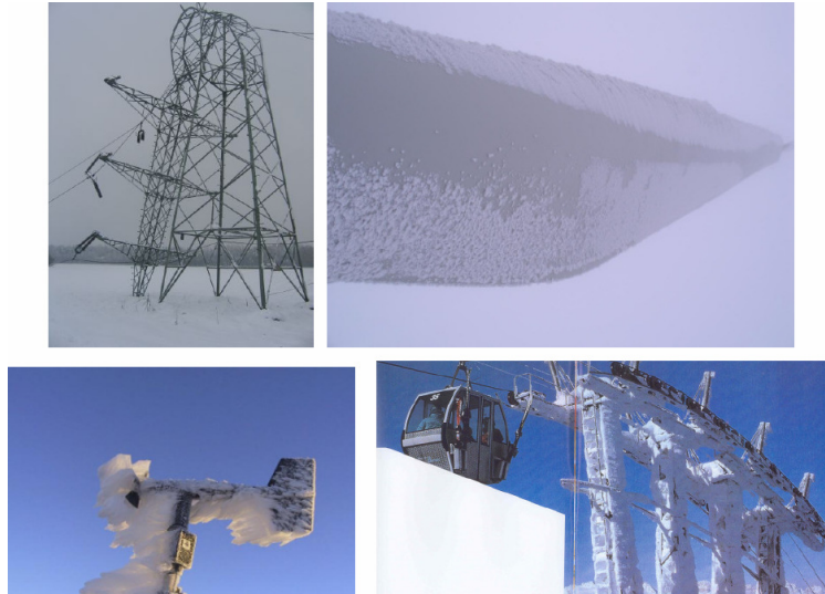
Abb. 15: Die Vereisung an Strukturen betrifft viele Bereiche. Oben links: Wegen Vereisung eingestürzter Mast einer Hochspannungsleitung. Oben rechts: Vereisung am Rotorblatt einer WEA. Unter links: Vereistes Propelleranemometer. Unter rechts: Vereisung am Mast einer Seilbahn.
