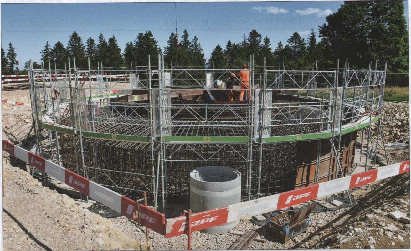
Le maillage des fers avant de recevoir les 350 m 3 de béton nécessaires par socle.
