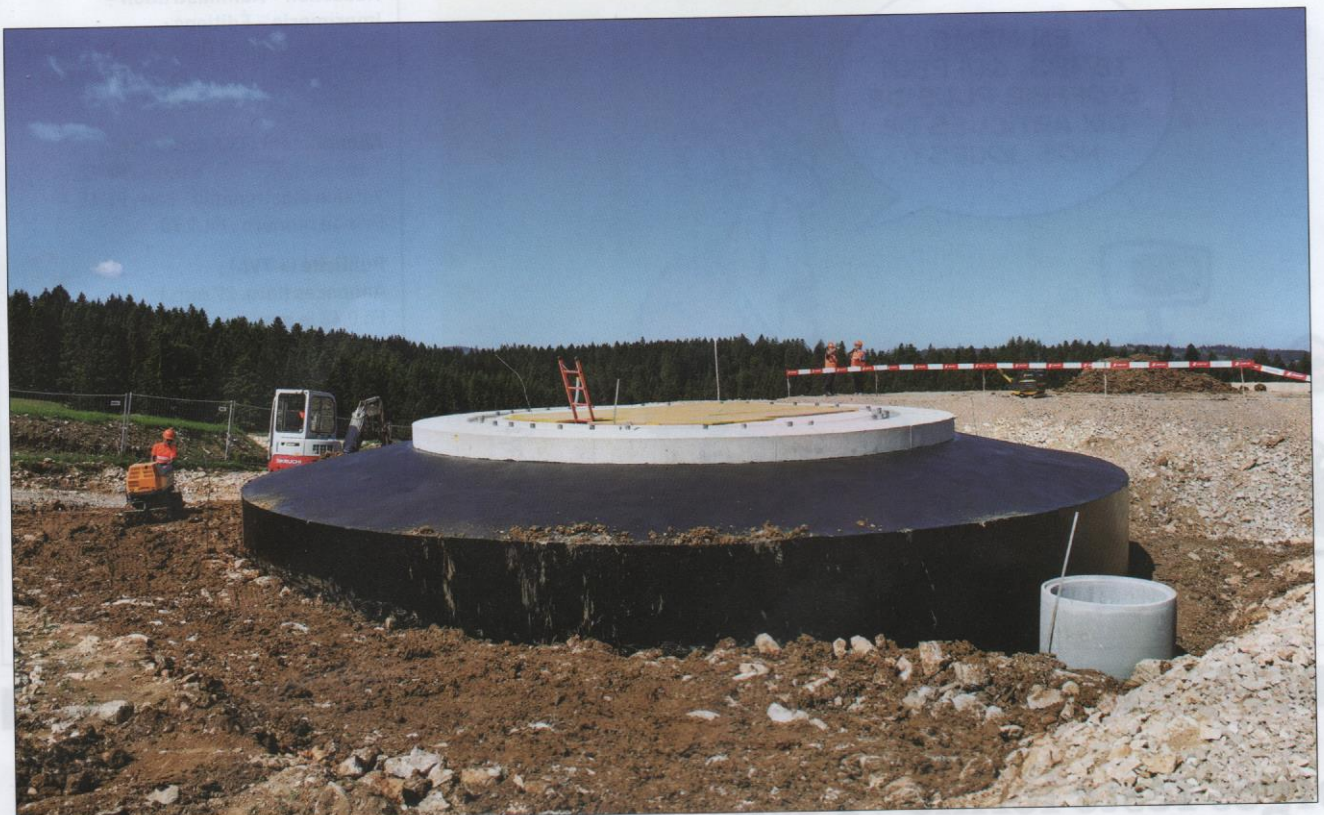
Les socles, une fois bétonnés, sont couverts d'un enduit hydrofuge. Ici le remblayage a débuté.
