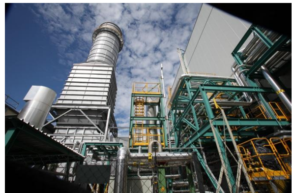
Abbildung 7: Birr-4 Brennstoff- und Abgasanlagen.
