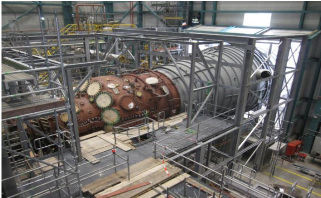
Abbildung 6: Installation der GT36 in der Birr-4 Anlage.
